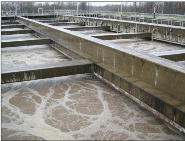
Traitement des eaux usées. Crédit photo : Marc Hébert.
